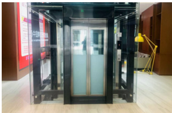
综合楼一楼指挥中心外垂直电梯
